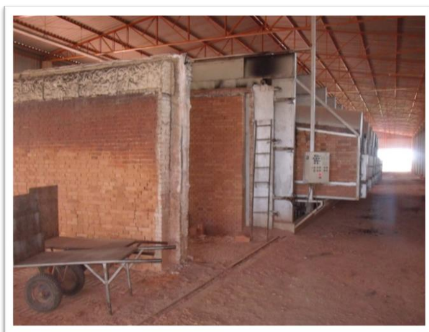
Figura 17: Vista Geral do Forno Túnel sobre Trilhos.
