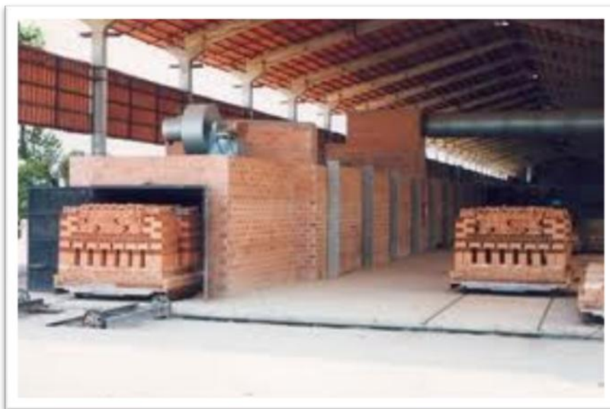
Figura 19: Vista do Forno Túnel com os Vagonetes sobre Trilhos.
