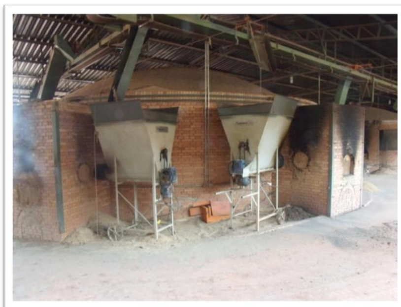
Figura 14: Forno Abóboda com Alimentação Automatizada II. Para serragem e cavacos de madeira.
