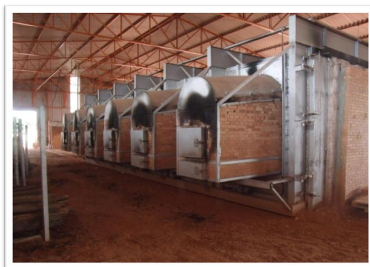
Figura 15: Vista Lateral dos Fornos Túnel sobre Trilhos.
